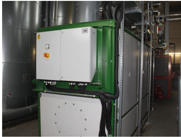
BHKW Quelle: EAM EnergiePlus GmbH
