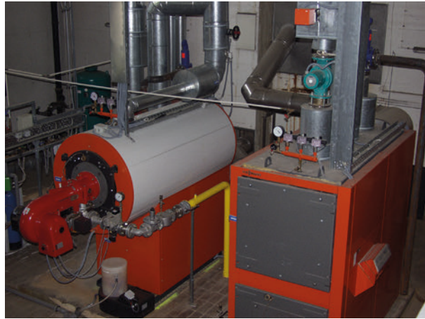
Die Erdgas-Kesselanlage wird zukünftig durch einen Fernwärmeanschluss ersetzt
